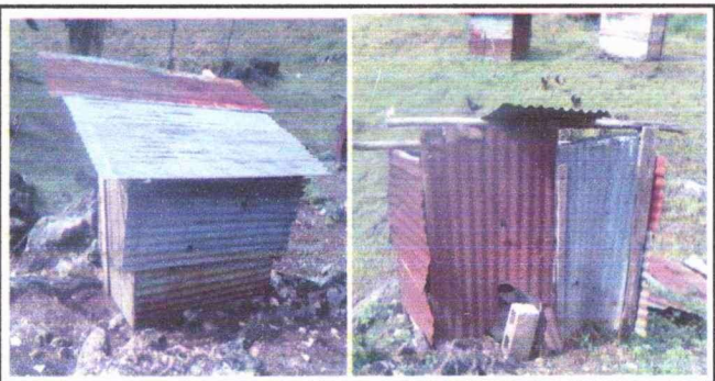
Foto 6: Se observa el mal estado de las letrinas del establecimiento educativo.
