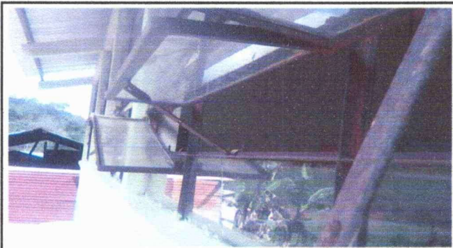
Foto 3: Se observa el deterioro de los vidrios del aula 2.
