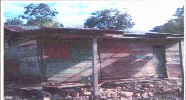
Foto 2: Se observa el mal estado de esta aula.
