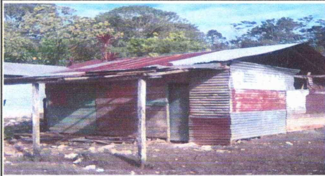
Foto 1: Se observa el deterioro de esta aula.
