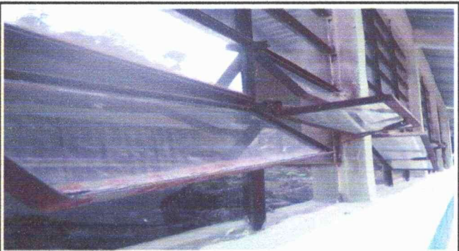
Foto 4: Se observa el mal estado de las ventanas del aula 2.
